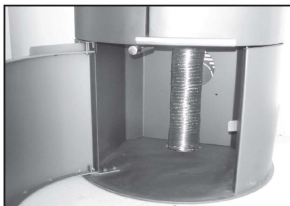
Uteluftsslangen bör kondensisoleras
